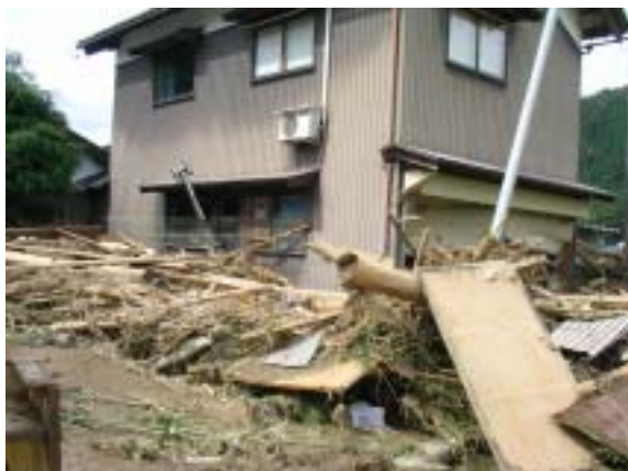
写真 3 洪水流と流木により損壊された家屋．福井市安波賀中島町．図 5 の B 地点．
