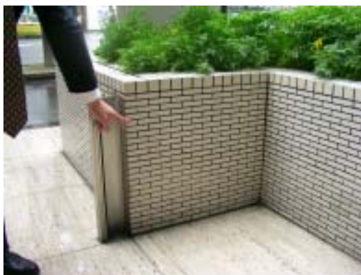
写真-1 博多都ホテルの止水板取り付け金具．指の位置まで浸水したとのこと
