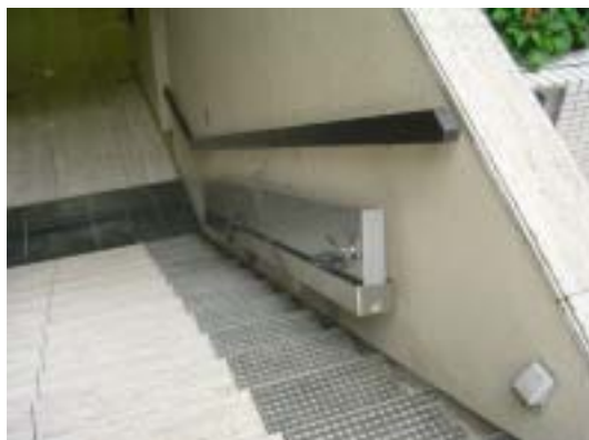
写真-2 設置箇所脇に用意されている止水板
