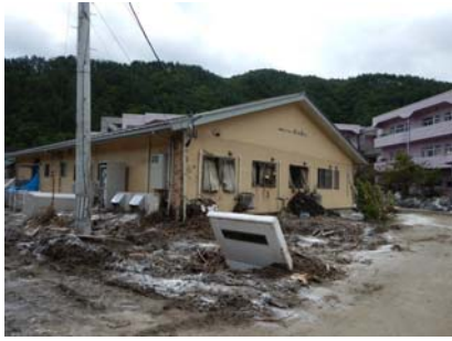
写真1 9人が死亡したグループホーム。1階天井まで浸水だが、建物の倒壊・流失はしていない。
