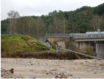
写真 3 北海道清水町清水第一線. 橋梁取り付け部道路が流失, 車が転落し 1 人が行方不明.
