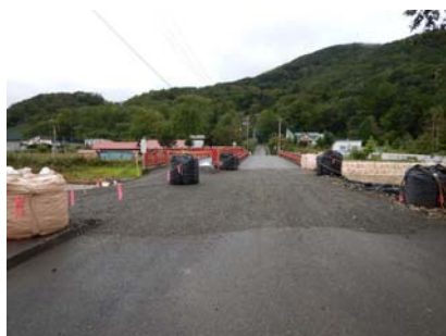
写真5 北海道新得町西二条. 避難途中の車が橋の取り付け部道路の流失箇所転落し、1人が死亡。
